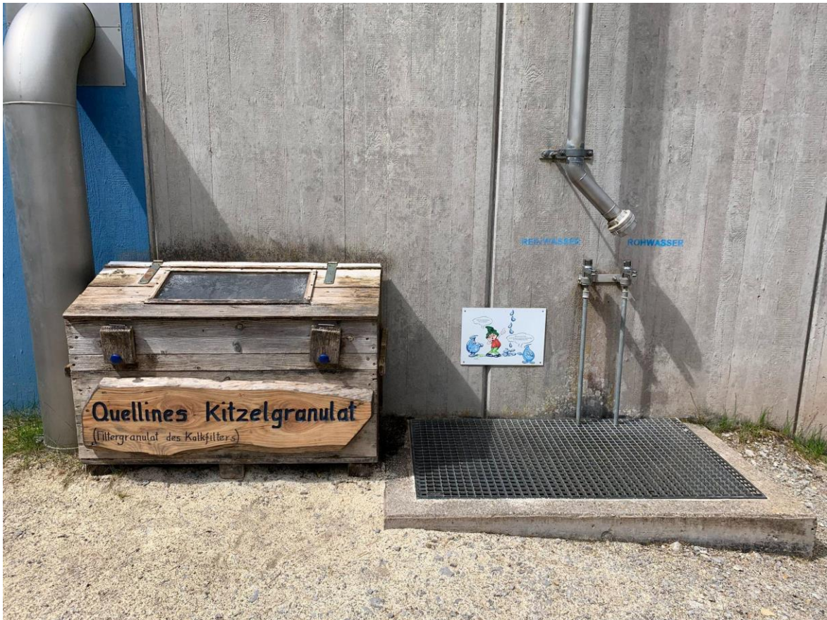
Abbildung 6: Kalter Wasserspeicher bei „Wie Wohnt Wasser?“ Unterkirnach (Quelle: eigene Aufnahme)
